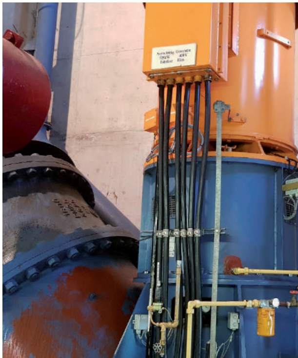
Generator (orange) im 180 KW Wasserkraftwerk
